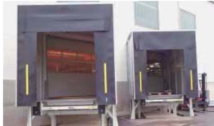
Vorschubbrücken in Stahlvorbauten integriert
