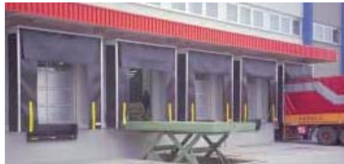
Kombination Tür, Ladebrücke, Hubtisch, Wetterschutz
