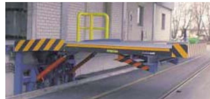
Gleisleger für Waggon-Entladung
